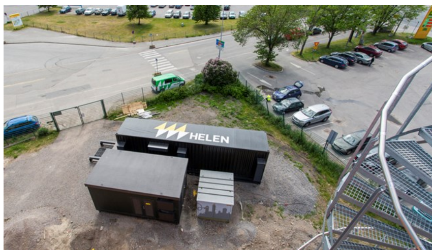
Kuva 4. Helen Suvilahden sähköakku (teho: 1,2 MW, Energiakapasiteetti 600 kWh, koko 12x2x2 metriä, investointikustannus noin 2 miljoonaa euroa) (kuva: www.helen.fi )
