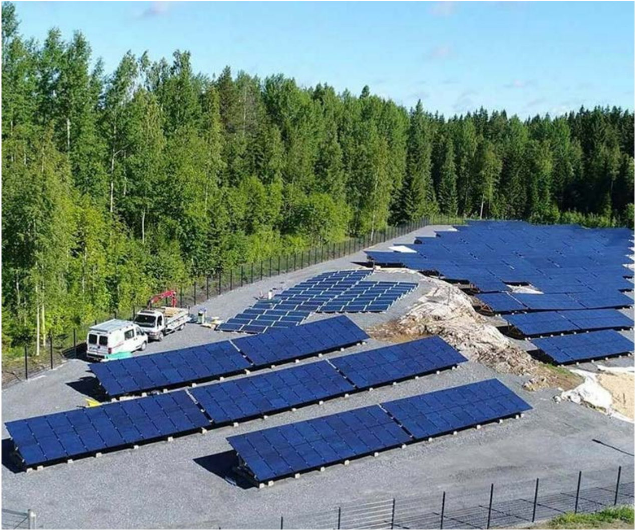
Kuva 17. Etelä-Savon Energia Oy:n aurinkovoimala, josta on haluttu ekologisuudesta ja uusiutuvista energiamuodoista henkivä maamerkki 5-tien varteen. Kaksi eri toimittajaa tukee aurinkopuiston yhtä suurinta tarkoitusta, joka on kerätä ja analysoida dataa mm. energian tuottamiseen ja säätiloihin liittyen. Kahden eri toimittajan paneeleita voidaan jatkossa verrata ja käyttää niistä kerättyä dataa mm. tuotekehitykseen. Lisäksi aurinkovoimala tulee toimimaan uudenlaisena oppimisympäristönä eritasoisille oppilaitoksille ja korkeakouluille sekä yritysten TKI-toimintaa tukevana yksikkönä. Se tarjoaa mahdollisuuden paikallisten yritysten tuotekehitykselle ja innovoinnille, jolloin myös maakunnallisesti uusien työpaikkojen syntyminen mahdollistuu. Pitkäjärven aurinkovoimalan rakentamisessa on alusta asti huomioitu ympäristöasiat ja ekologisuus. Ennen rakennustöiden aloitusta huolehdittiin, että liito-oravien pesäpuita ei vahingoiteta. Maanrakennustöissä on tehty vain välttämättömimmät toimenpiteet ja esim. tontilla olevaan kalliota ei poisteta louhimalla, vaan vain pintamaa poistetaan aurinkopaneelitelineiden alta. (Ote ESE:n lehdistötilaisuudesta tammikuussa 2017) Kuvälähde: Etelä-Savon Energian Instagram-tili 19.7.2017.
